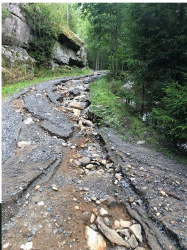
Til høyre: Litt fra skadene i Badstudalen
